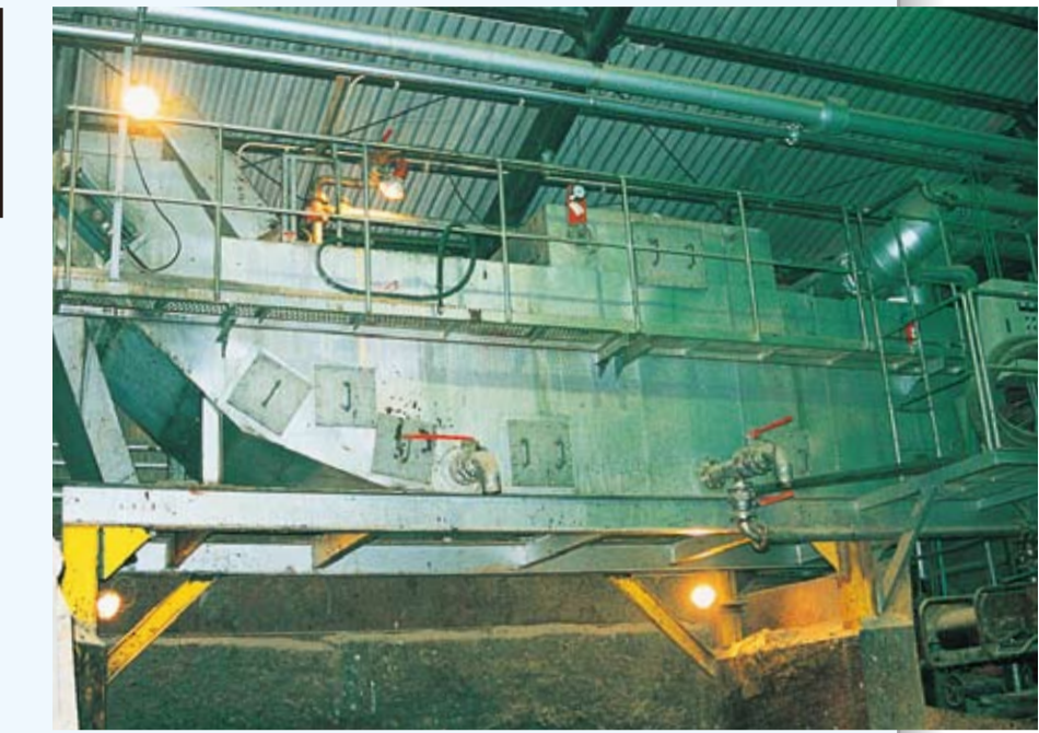
廃水濃縮晶析器 (第2濃縮器)
